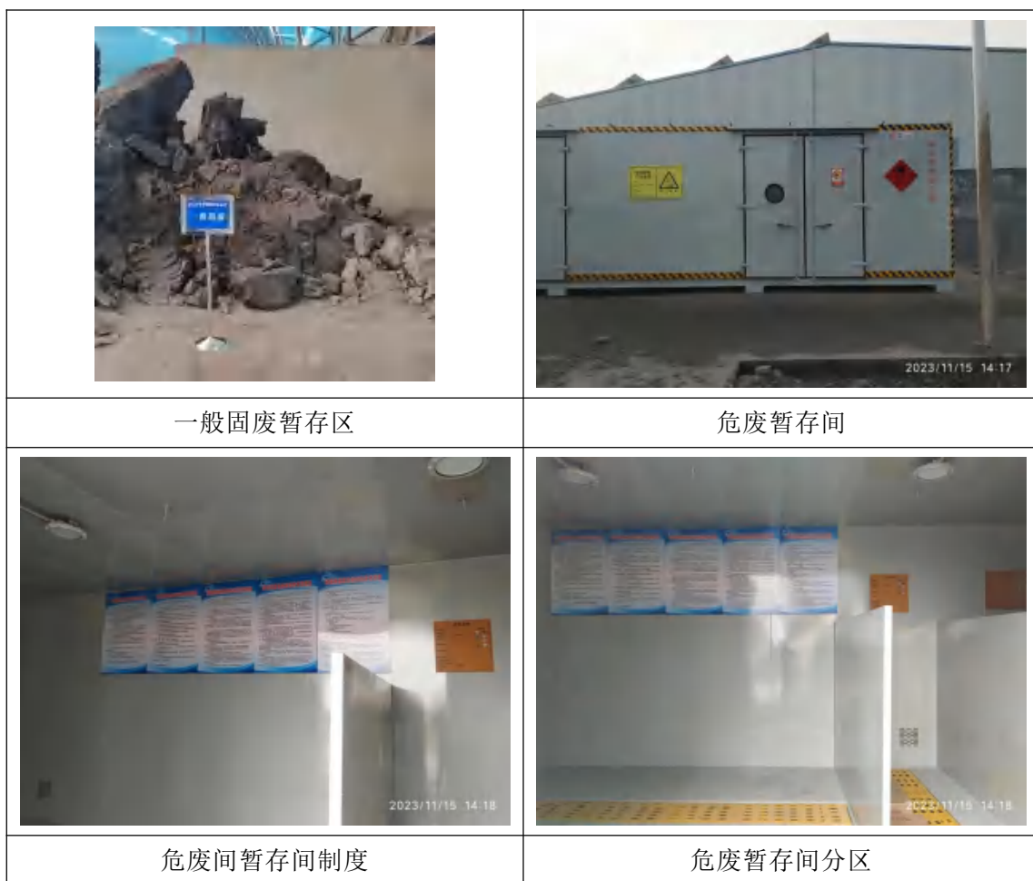
图 4-3 固废处理设施实际建设情况
